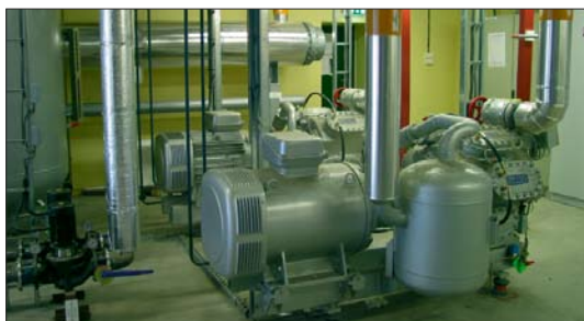
Bilde 2: Installasjon av varmepumpe i forbindelse med prosessanleggene gir ofte god økonomi.
