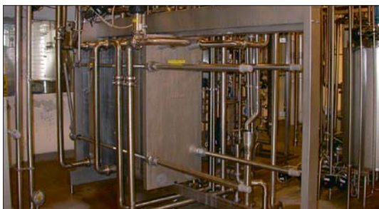
Bilde 11: Bilde viser plateveksler i produksjonsanlegget for gjenvinning av energi.
